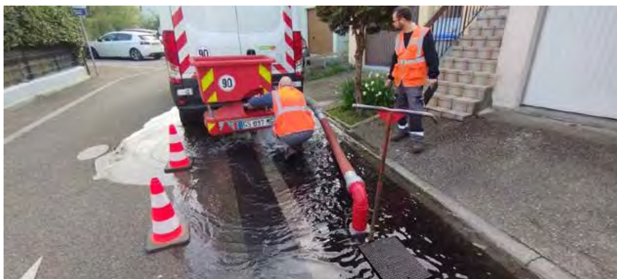
Test d'une bouche incendie
