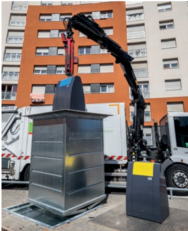
Les conteneurs enterrés permettent de limiter les erreurs de tri.
