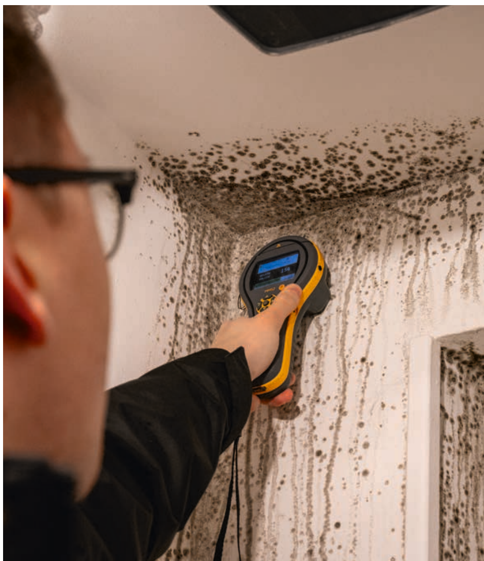
Se traduisant notamment par des moisissures sur les murs, les problèmes d'humidité constituent la première cause de saisine du service Hygiène et santé. © J. DORKEL
