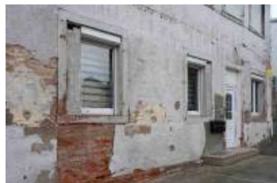
Logement vétuste à rénover
